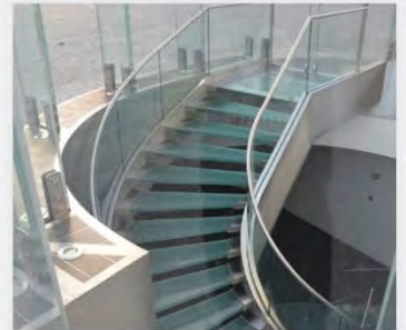
barrera protección, escalera,
